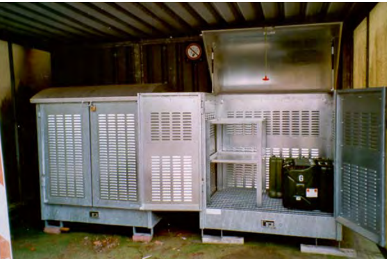
Abb. 3 Lager für Kraftstoffbehälter im Freien
